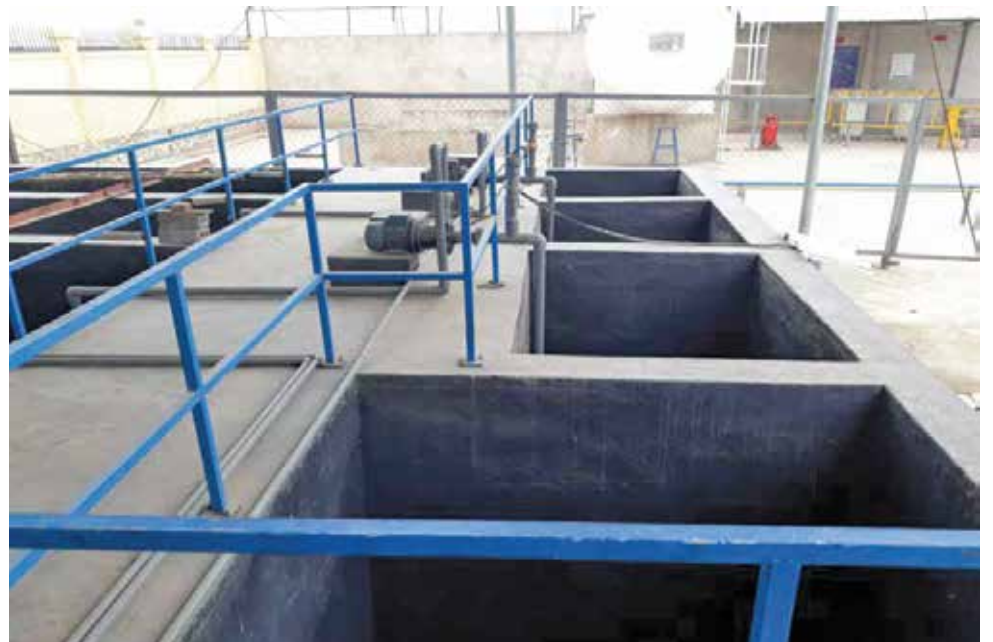
Hệ thống xử lý nước thải
